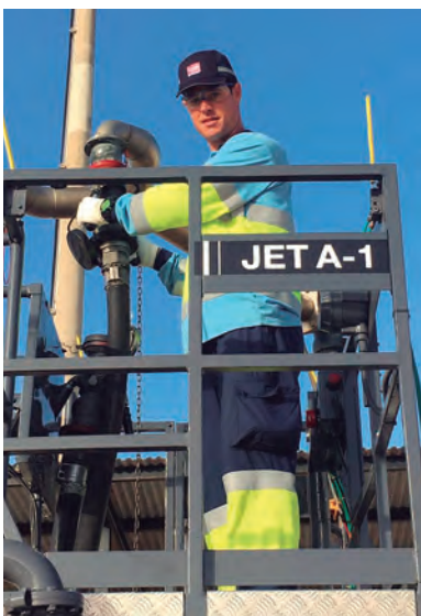
Óscar Alonso comprueba un dispenser antes de un suministro.
