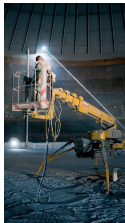
arriba: Las plataformas elevadoras son los equipos de elevación más usados en las instalaciones del Grupo CLH.
